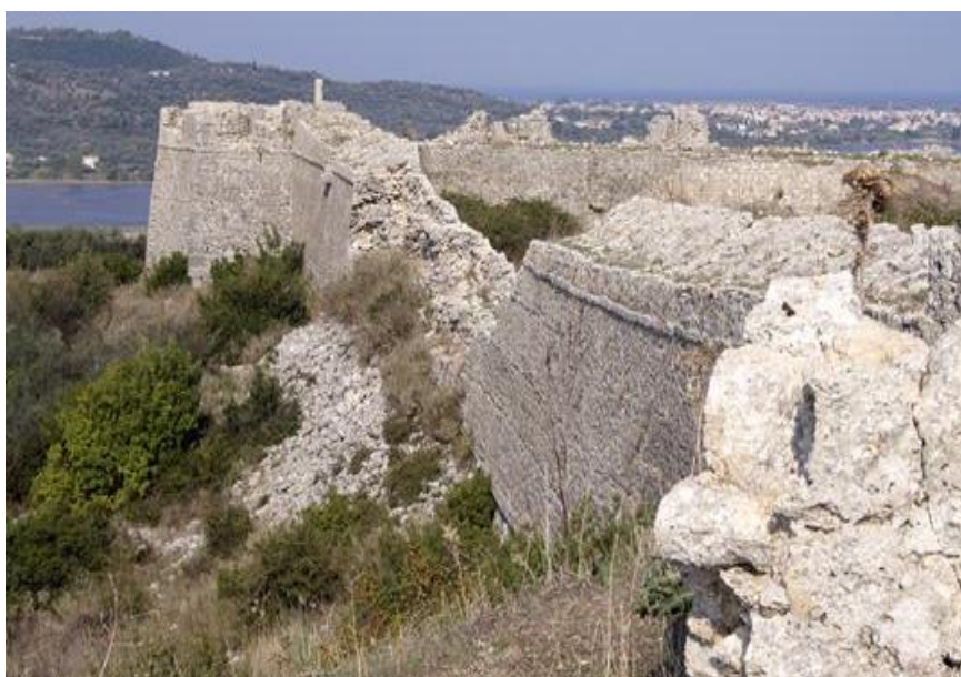
Εικόνα 5.4 Κατάρρευση τμήματος της δυτικής πλευράς της οχύρωσης
